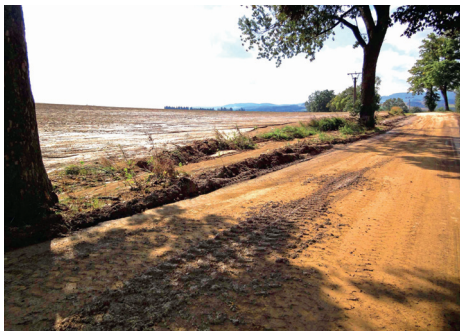
Vzniklé škody na komunikacích
