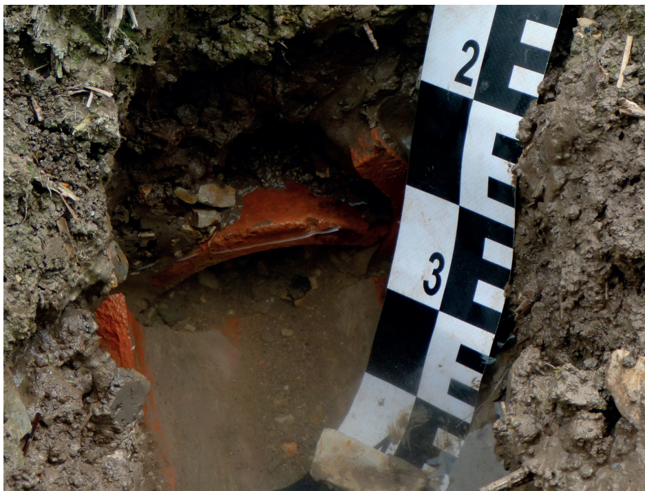
Poškozená drenážní trubka
