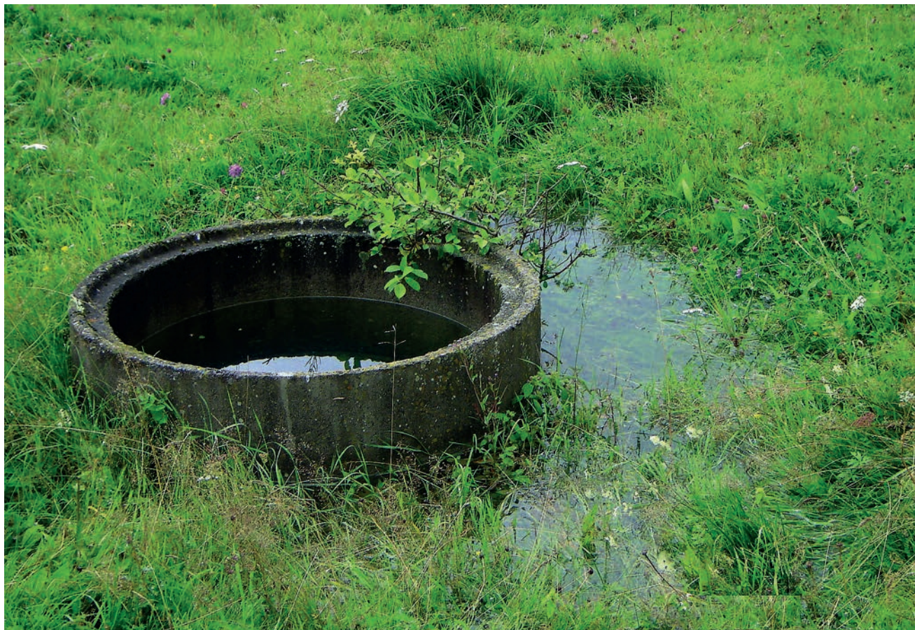
Nefunkční drenáž Zdroj: VÚMOP, v. v. i.
